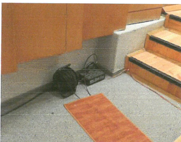
Kábelek, csatlakozók a közlekedőben.
