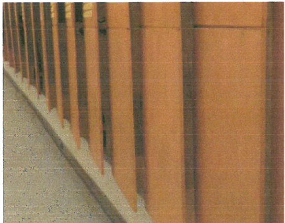
Szakadozott szövetbetétek a fa burkolólapok között.
